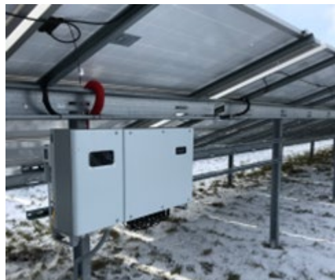
Figur 1 Eksempel på inverter.
